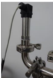
Figura 10. Traductor de presiune plasat pe traseul de pompare a apei purificate în vasele de reacție ale instalației pilot.
