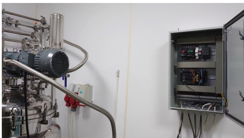
Figura 17. Amplasarea și racordarea dulapului de protecție al unei părți a instalației de automatizare la instalația pilot pentru obținerea suspensiilor coloidale de colagen.
