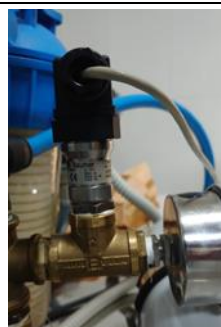
Figura 9. Traductor de presiune plasat pe traseul aducțiunii de apă purificată.
